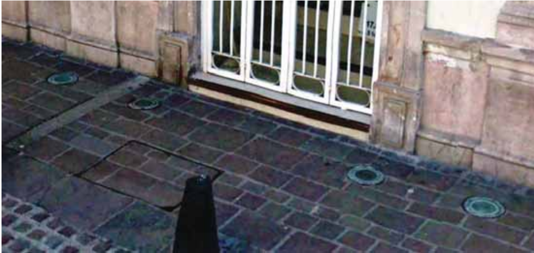
Dispone de alumbrado público. Luminarias empotradas en el piso.
